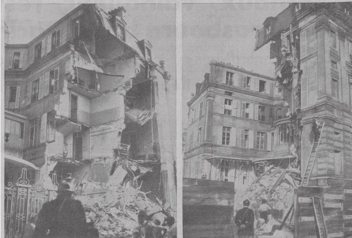
L'immeuble du numéro 4 de la rue de Presbourg, siège de la Confédération Générale du Patronat Français, complètement ouvert en deux par l'explosion d'une bombe à retardement.
